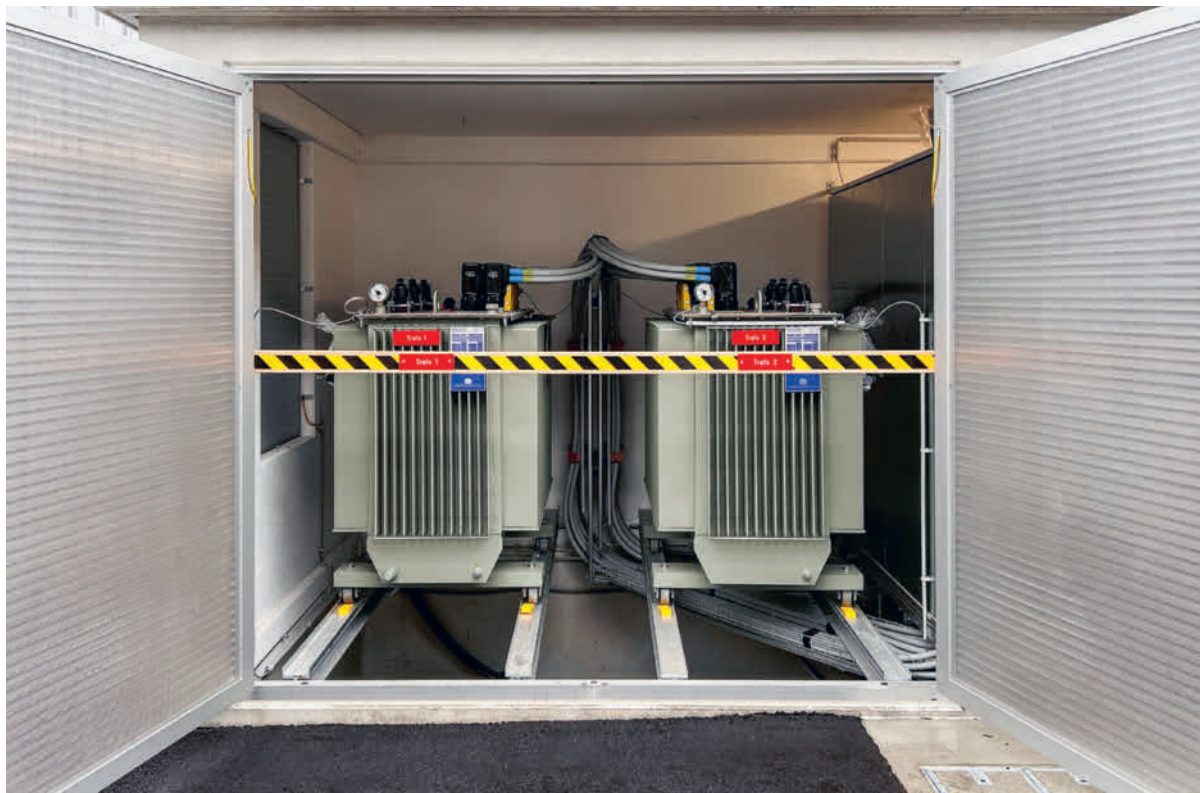
Transformatoren / Quelle TB Waldkirch
