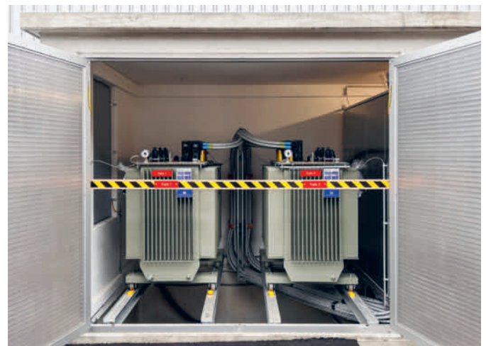
Transformatoren der neuen Trafostation Neubrunn
