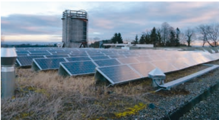
Die Energiestadt Waldkirch unterstützt den Bau von Photovoltaikanlagen
