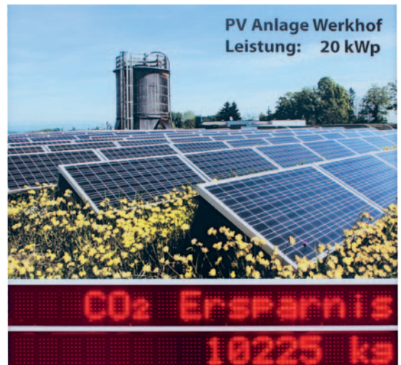
Anzeigetafel der Photovoltaikanlage auf dem Dach des Werkhofs Buechwiszen
