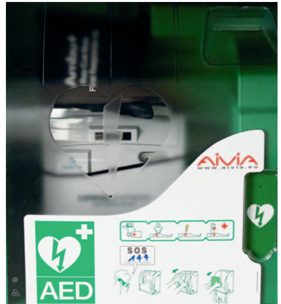
Installation eines Defibrillators bei den Raiffeisenbanken in Waldkirch und Bernhardzell
