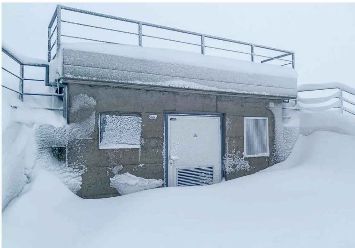
Trafostation Tannenberg, Waldkirch / Quelle TB Waldkirch
