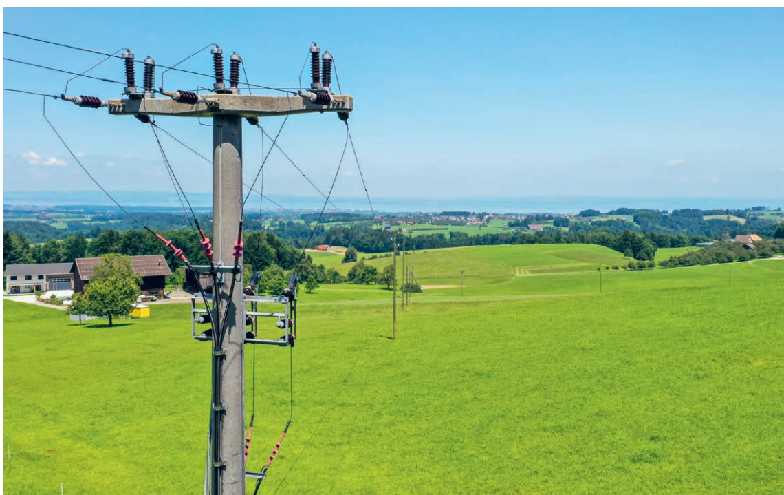
Freileitung Tierlihueb, Waldkirch / Quelle TB Waldkirch
