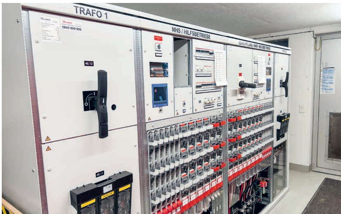
Niederspannungsverteilung MS St. Pelagibergstrasse / Quelle TB Waldkirch
