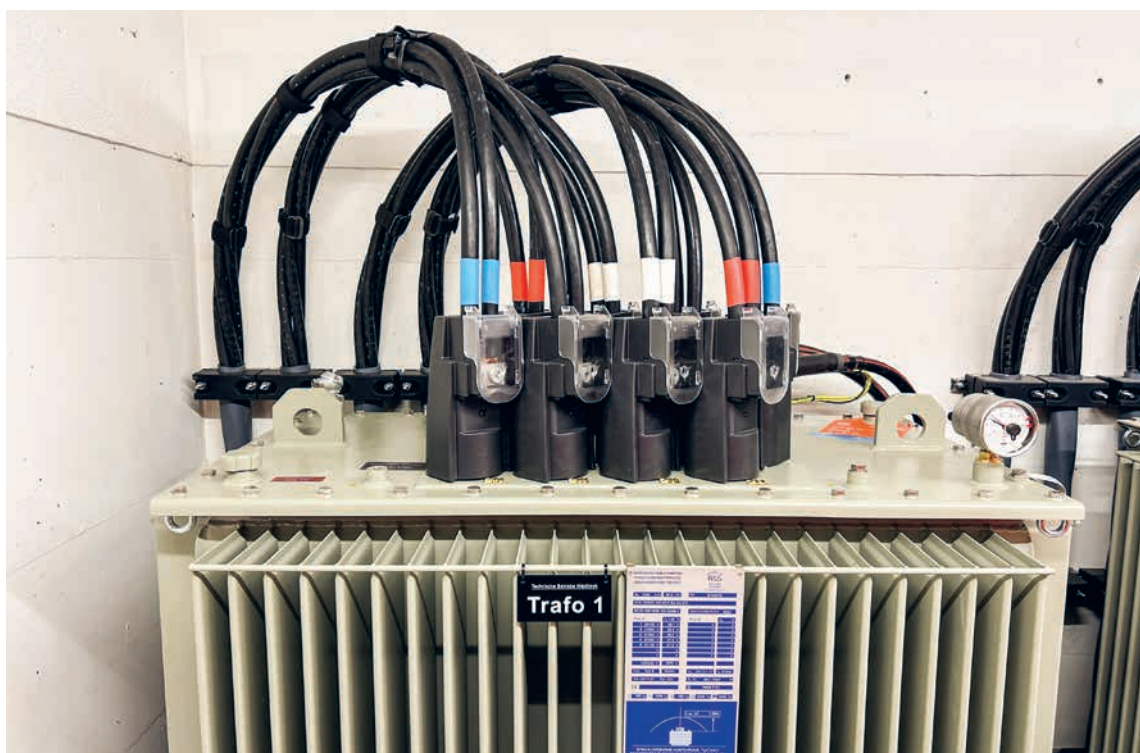
Messstation St. Pelagibergstrasse / Quelle TB Waldkirch
