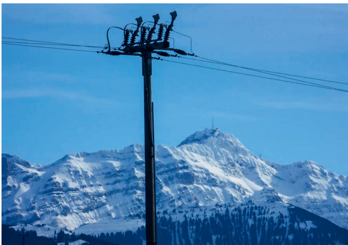
Freileitungsschalter vor Säntis/Quelle: TBW
